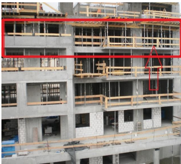
Rys. 6. Widok budynku wielorodzinnego w trakcie realizacji, z zaznaczeniem omawianej sekcji, (fot. K. Owczarska).
