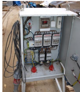
Rys. 5. Szafa sterownicza, (fot. K. Owczarska).
